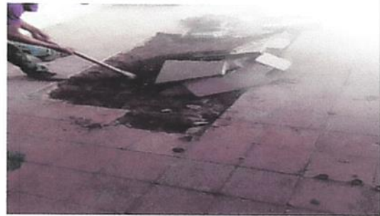
Foto 4: Retiro de piso en mal estado para instalacion de piso de granito
